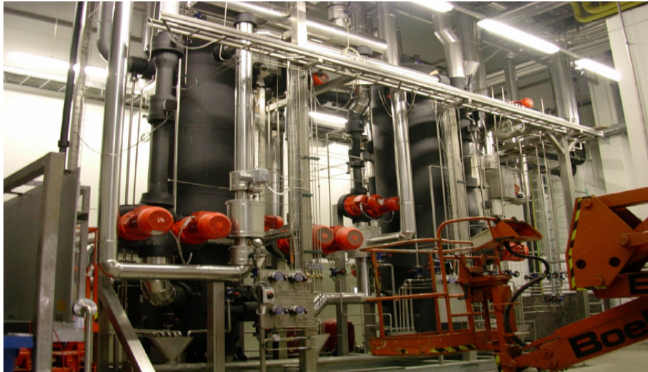
Foto: Kälte- und Kühlwasserverteilung 5,3 MW auf 4 Temperaturniveaus
